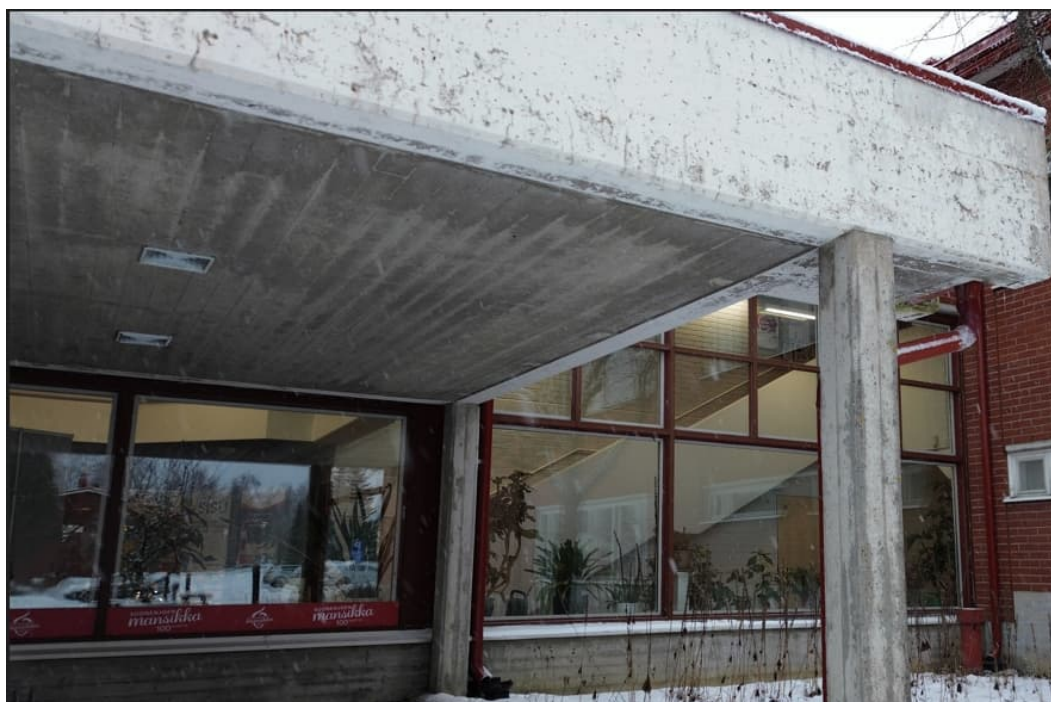
Kuva 12: Yleiskuva Pääsisäänkäynnin paikkakorjattava ja maalattava otsapalkki
