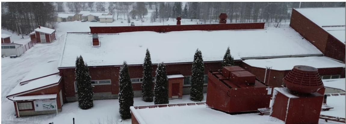
Kuva 9: Yleiskuva moduulin F-H/4-10 korjattavat vesikatot
