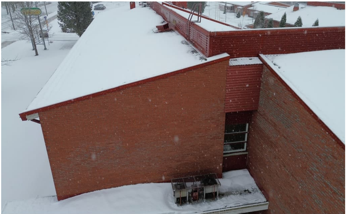
Kuva 7: Yleiskuva moduulin A-C/1-2 korjattava vesikatto
