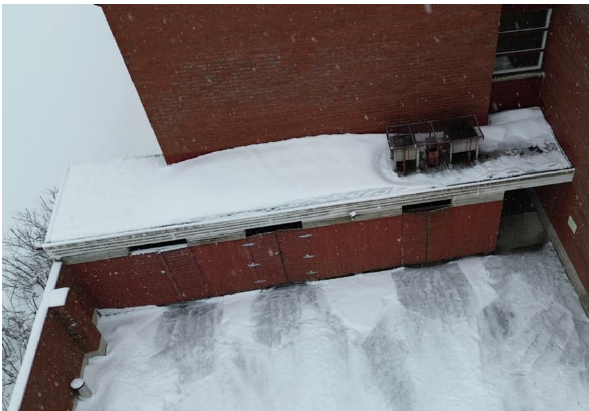
Kuva 5: Yleiskuva moduulin A-C/1-2 korjattava vesikatto
