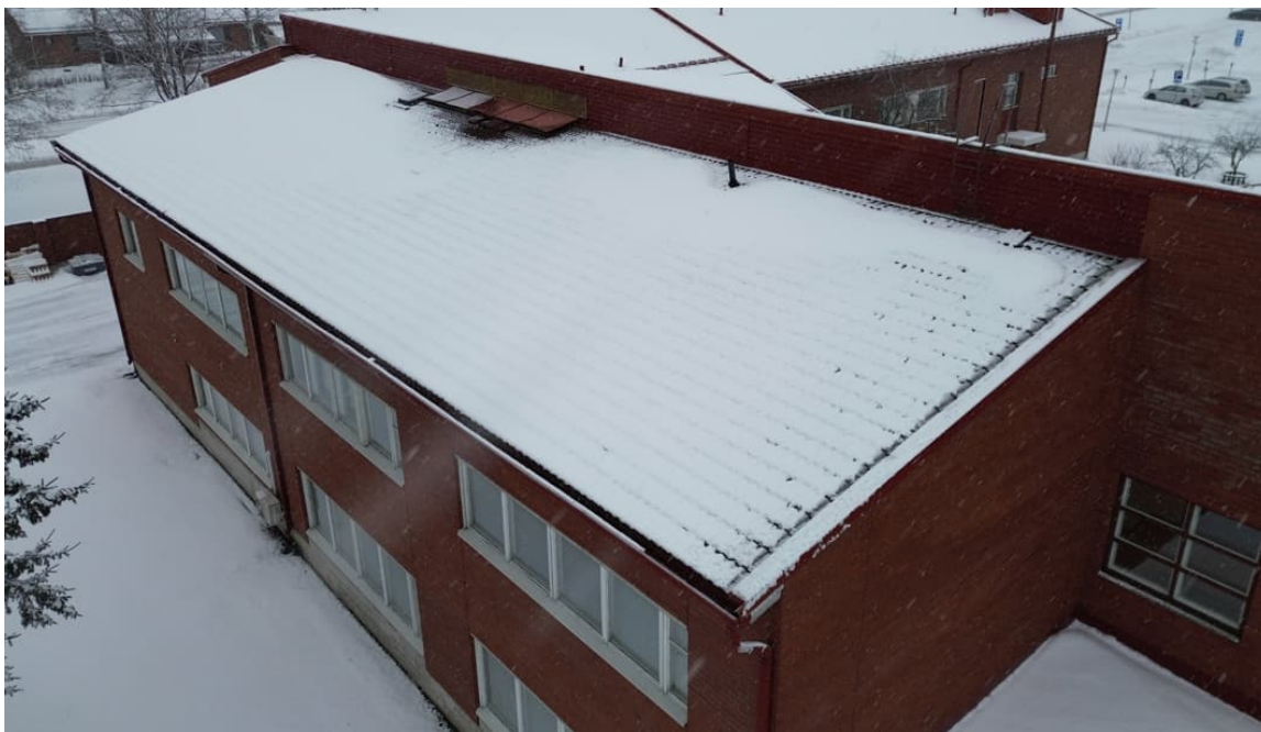
Kuva 4: Yleiskuva moduulin C-G/1-2 korjattava vesikatto
