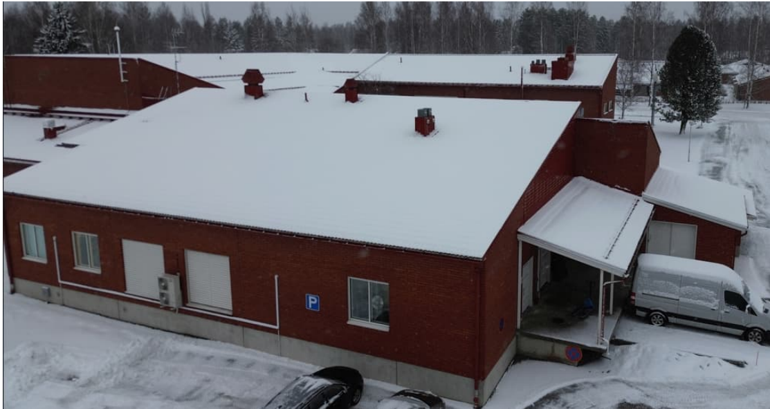
Kuva 2: Yleiskuva moduulin H-J/5-10 korjattavat vesikatot
