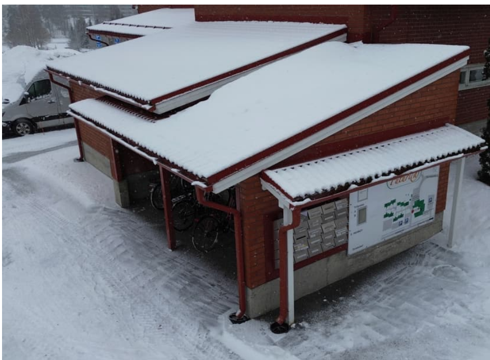
Kuva 15: Yleiskuva moduulin F-H/10 korjattavat vesikatot
