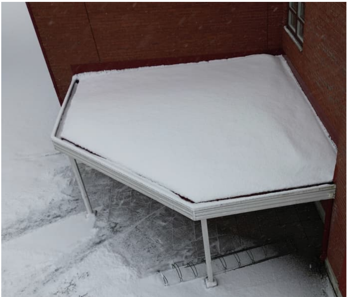
Kuva 3: Yleiskuva moduulin G-H/1-2 korjattava vesikatto
