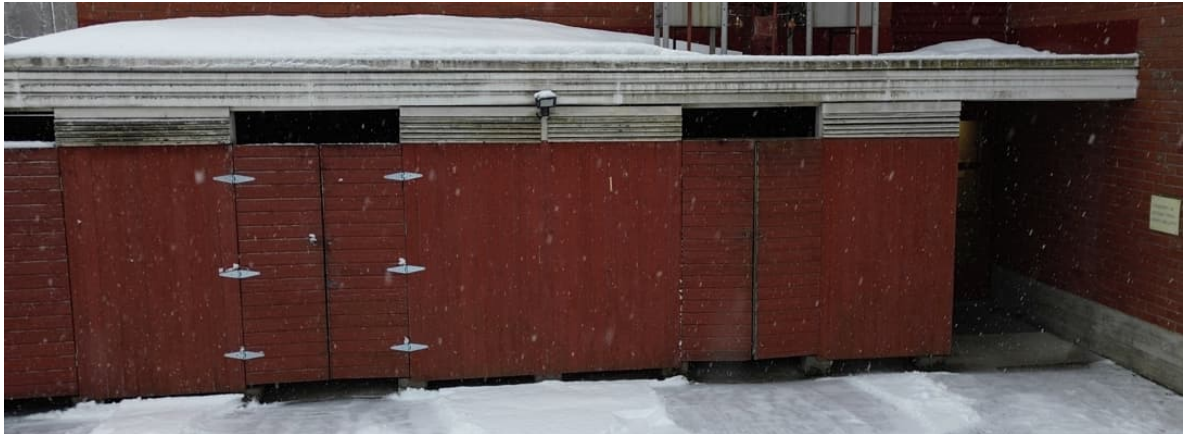
Kuva 6: Yleiskuva moduulin A-C/1-2 jätekatoksen oven yläpuolinen säleikkörimoitus uusitaan
