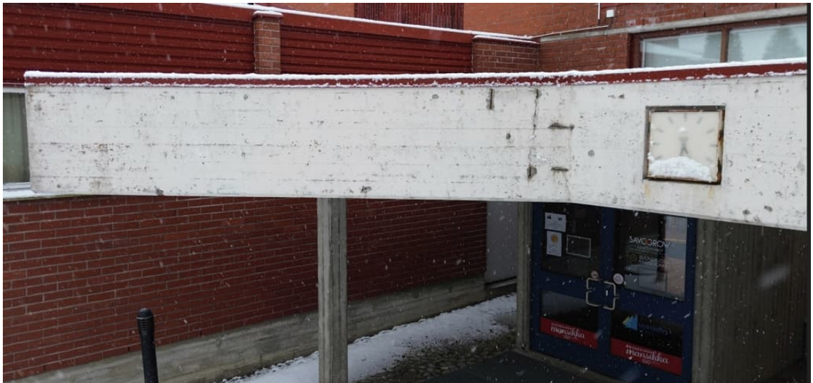
Kuva 11: Yleiskuva Pääsisäänkäynnin paikkakorjattava ja maalattava otsapalkki
